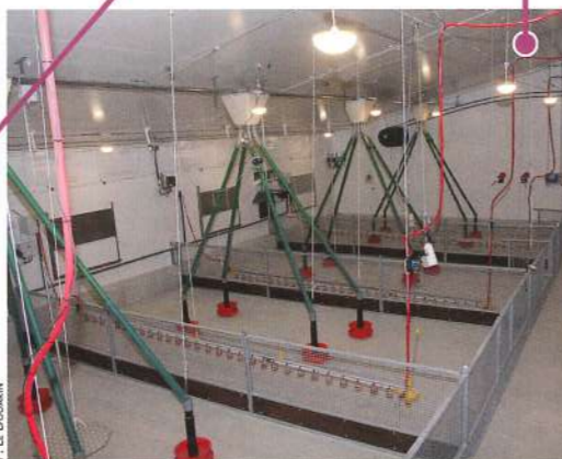
▲ LES DEUX ÉCHANGEURS DE CHALEUR DE CHALEUR, placés du côté admission d'air par dix volets, vont permettre de réduire encore le coût de chauffage et de mieux maîtriser l'hygrométrie. Remarquer aussi les fenêtres à guillotine (fermées à ce moment).
